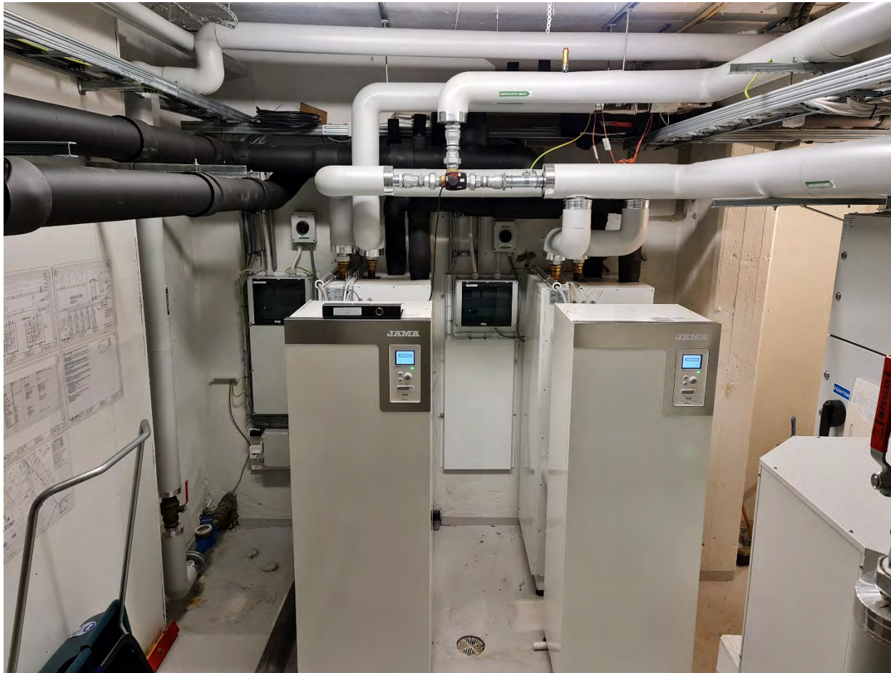
2 kpl JÄMÄ STAR 60 kW lämpöpumput
